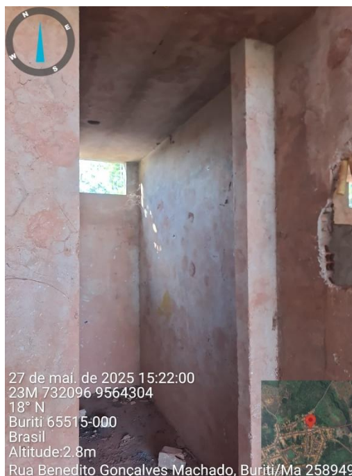
Figura 51: Não ná verga no depósito. Fonte: Fotografia in loco, elaboração própria.
