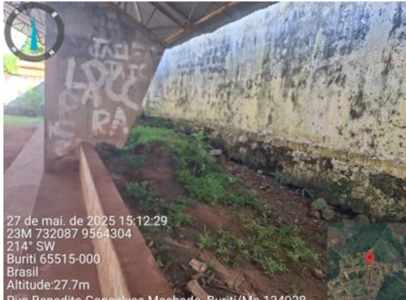
Figura 24 – Canaleta de drenagem pluvial não executada. Fonte: Fotografia in loco, elaboração própria.
