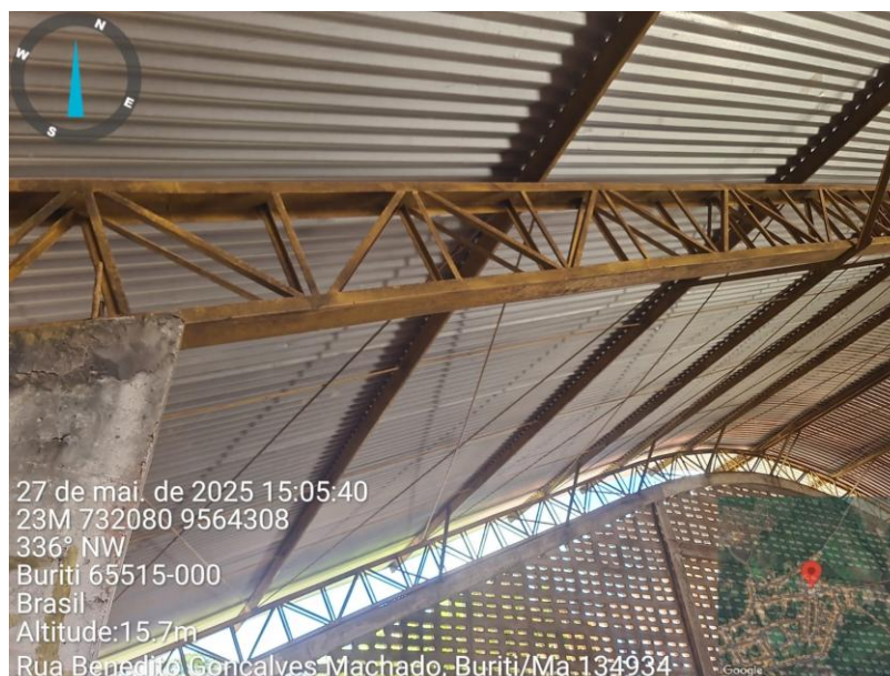
Figuras 40 e 41: Arcos metálicos executados com 50cm ao invés de 80 cm como esta no projeto. Fonte: Fotografia in loco, elaboração própria.
