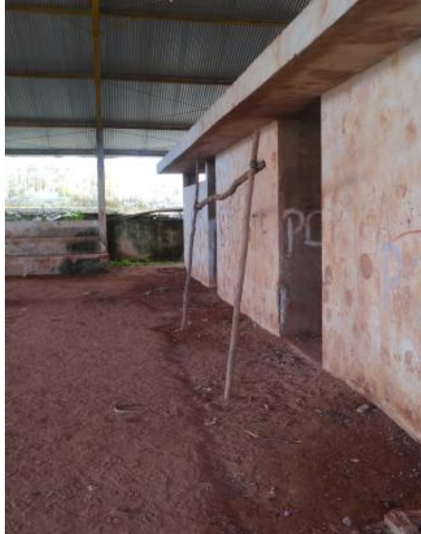
Figura 15 – Não executado contrapiso e piso. Fonte : Fotografia in loco, elaboração própria
