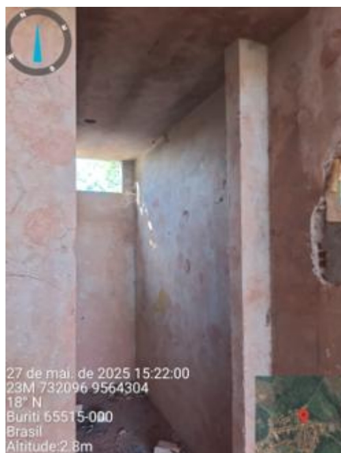
Figura 53: Não há verga no depósito. Fonte: Fotografia in loco, elaboração própria.
