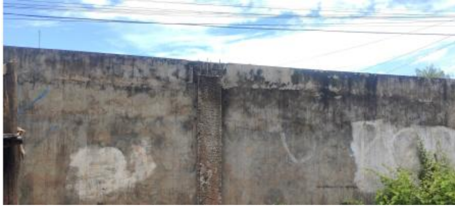
Figura 4 – Muro lateral. Fonte : Fotografia in loco, elaboração própria..
