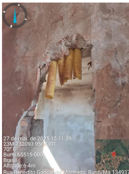
Figura 46: Eletrodutos flexíveis. Fonte: Fotografia in loco, elaboração própria.
