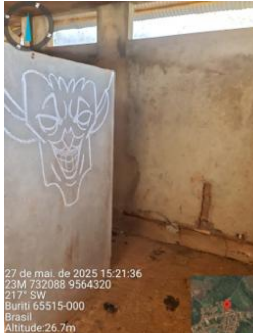
Figura 21 – Instalações sanitárias não foram instaladas. Fonte : Fotografia inloco, elaboração própria
