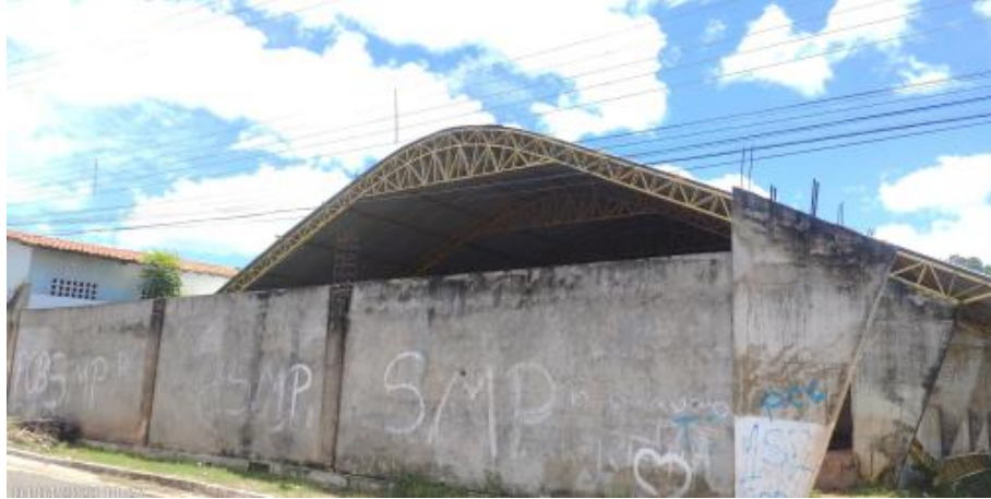
Figura 17 – Estrutura executada apenas reboco, sem pintura.. Fonte : Fotografia in loco, elaboração própria
