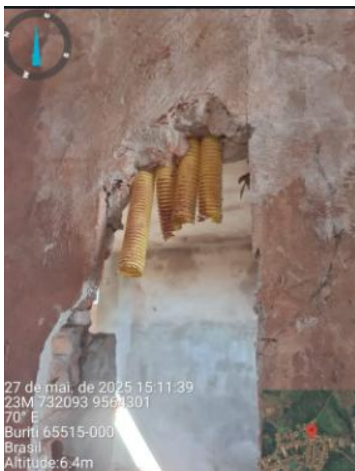
Figura 60: Eletroduto flexível. Fonte: Fotografia in loco, elaboração própria.
