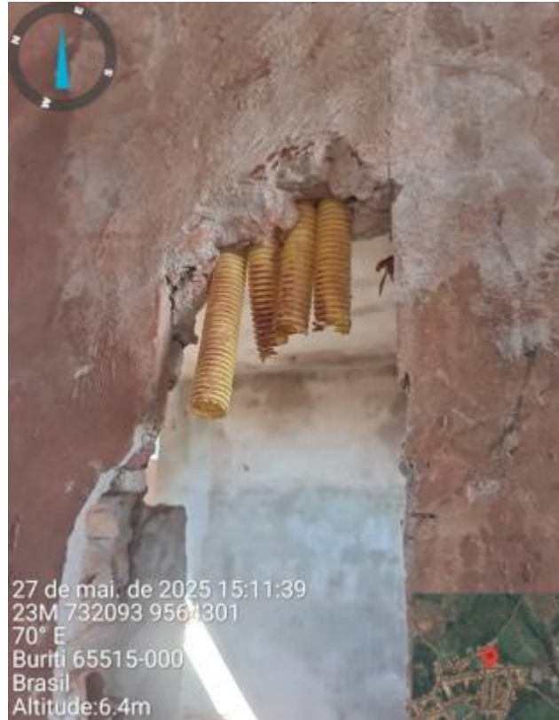
Figura 26 – Eletroduto flexível. Fonte: Fotografia in loco, elaboração própria.
