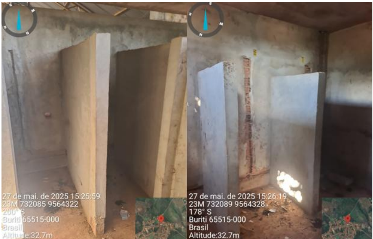
Figuras 22 e 23 – Instalações sanitárias não foram instaladas. Fonte : Fotografia inloco, elaboração própria
