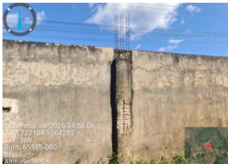
Figura 3 – Muro lateral. Fonte : Fotografia in loco, elaboração própria..
