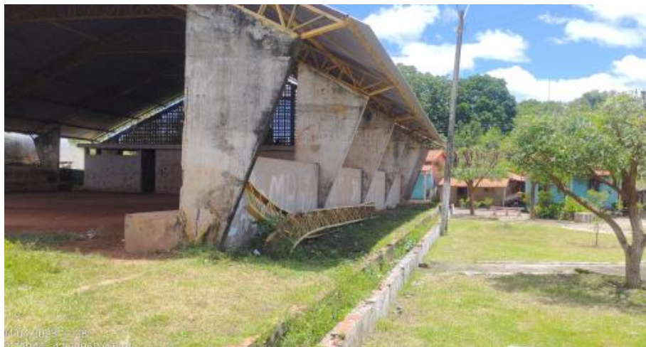
Figura 18 – Estrutura executada apenas reboco, sem pintura.. Fonte : Fotografia in loco, elaboração própria
