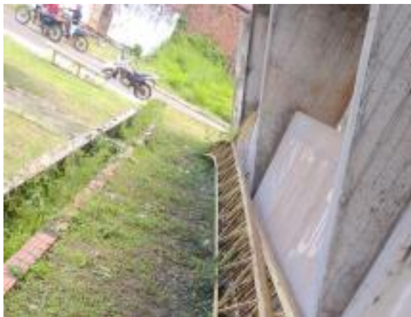
Figura 25 – Canaleta de drenagem pluvial não executada. Fonte: Fotografia in loco, elaboração própria.
